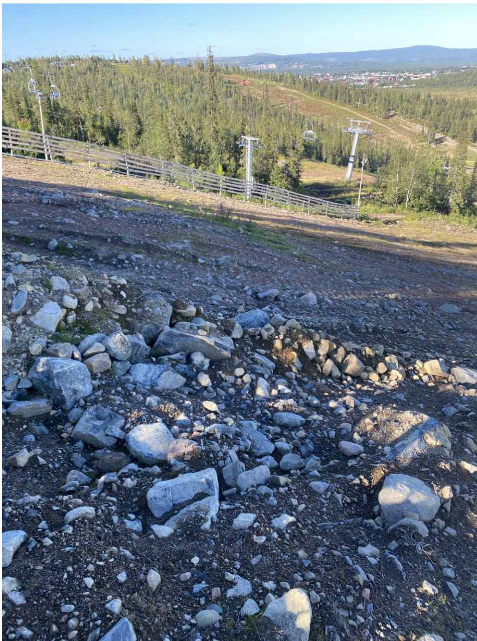
Figur 33. Frånvarande växttäck. Vatten trycker ut ur slänten. IMG_7433.jpg.
