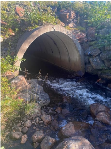
Figur 23. Vägtrumma med inspektionsbehov. IMG_7190.jpg
