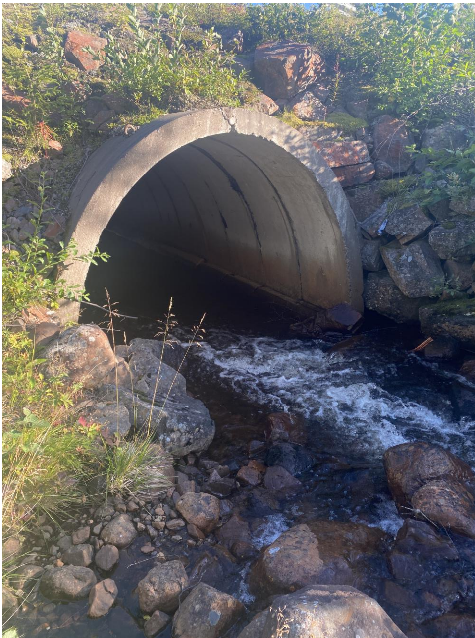
Figur 6. Kulvert under väg. Notera missfärgningen som indikerar en vanlig högvattennivå 0,5 meter över den vid fältarbetet aktuella. IMG_7190.jpg.
