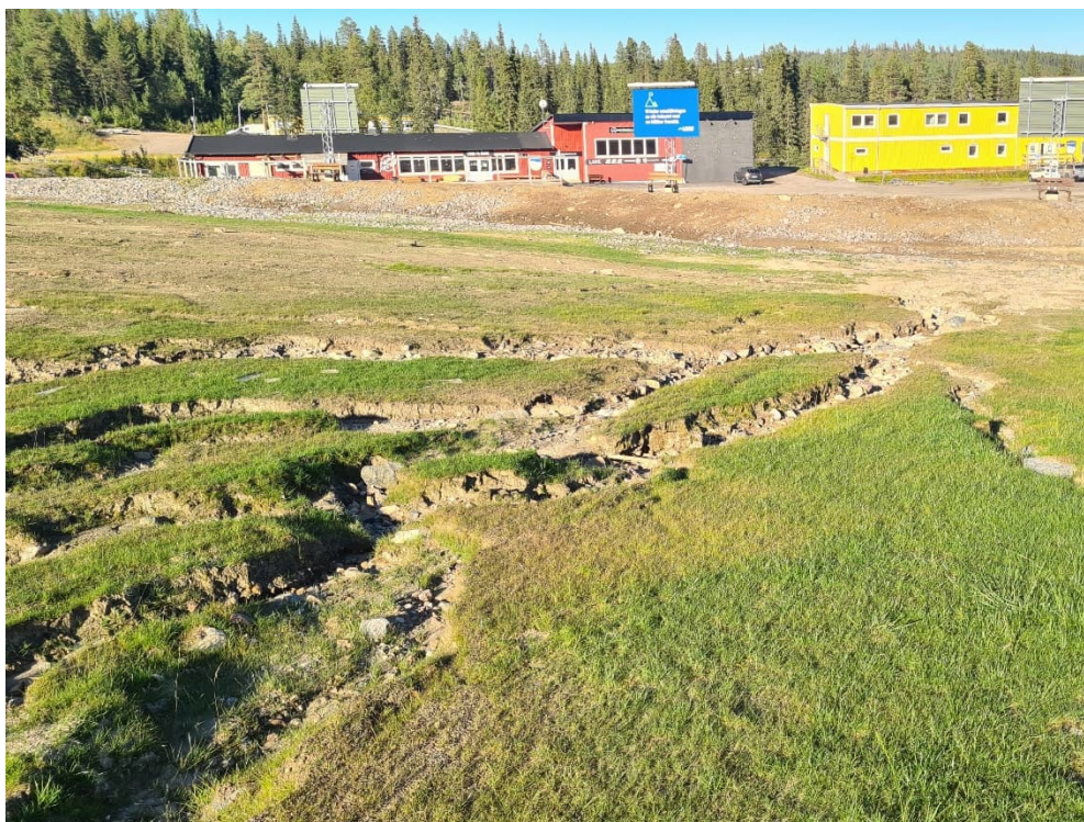
Figur 21. Erosionsfåror i nedre del av slänt (ur Norconsult, 2022-06-30).
