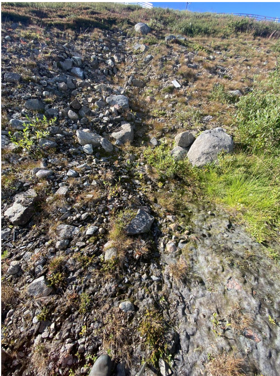
Figur 26. Blottad jord samt eroderat, transporterat och återavsatt finmaterial (nedre högerhörnet). IMG_7365.jpg.
