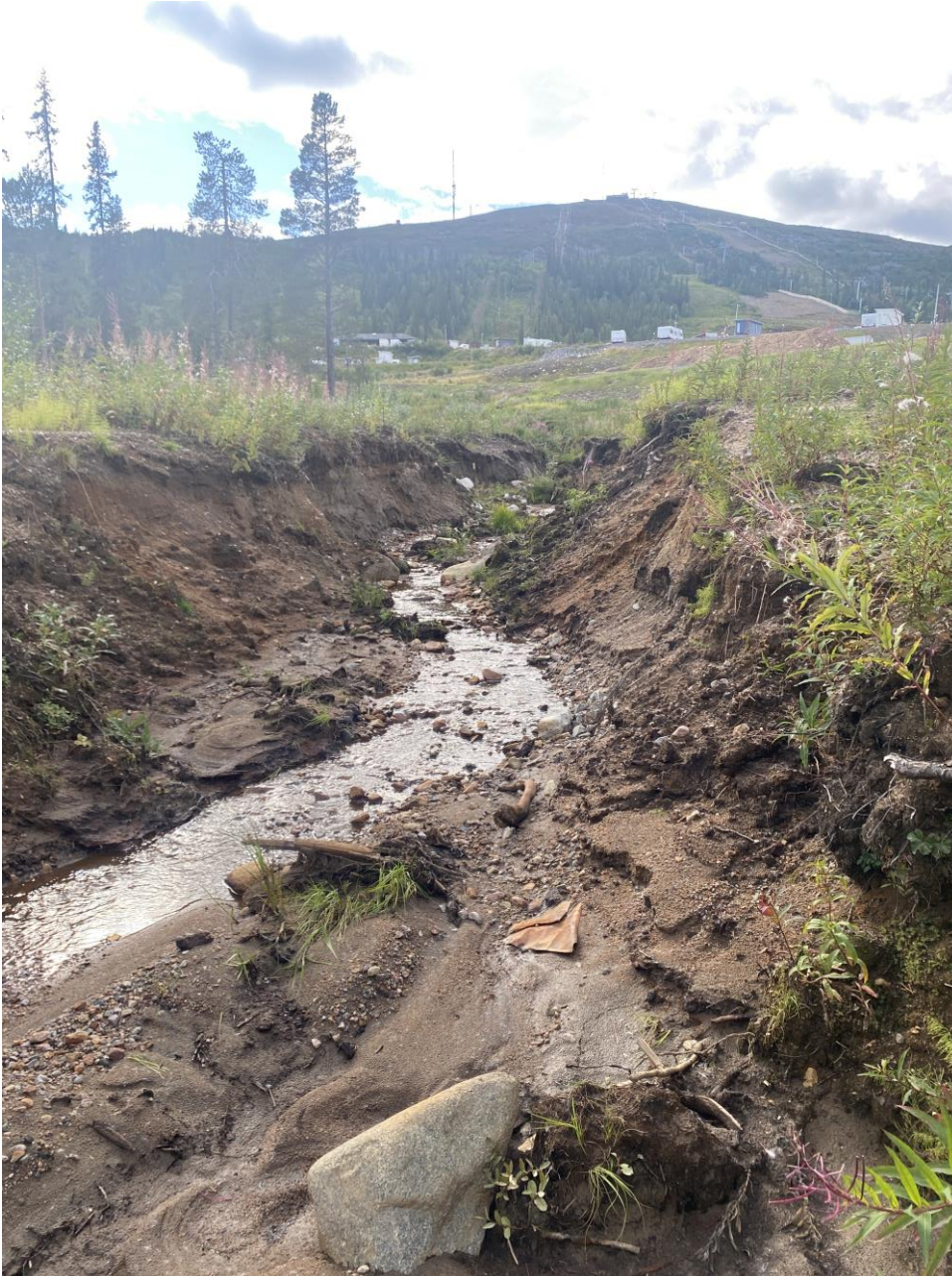
Figur 1. Bäck-/dikesavsnitt innan anslutning till kontrollerat dike. Erosion förekommer som synes, troligen orsakad som en anpassning till bottennivån i dike 5. Erosion har skett nedströms släntfot (bakom husbilar), d.v.s. topografiska förutsättningar för slamströmmar saknas. IMG_7116.jpg.
