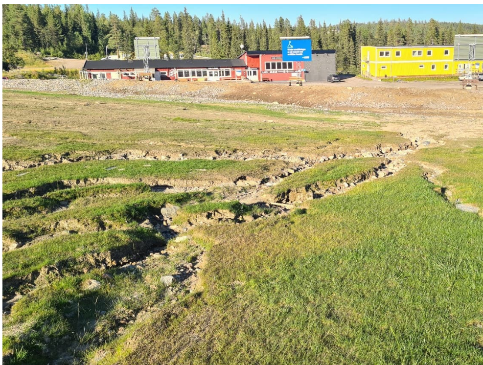
Figur 3 Erosionsfåror i nedre del av slänt
