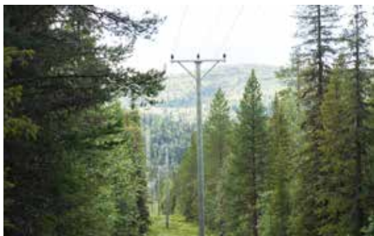
Kraftledningen mot Dundret i områdets västra del.
